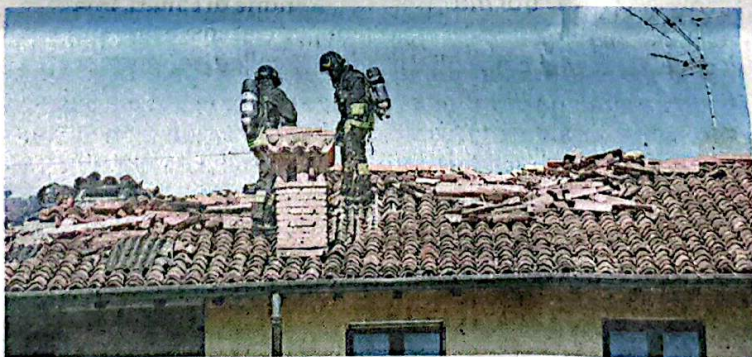
Devastato. Il tetto della palazzina fortemente danneggiato dall'azione del fuoco
