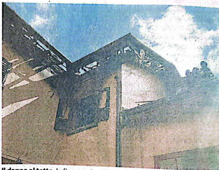
Il danno al tetto. In fiamme circa 10 metri quadrati
