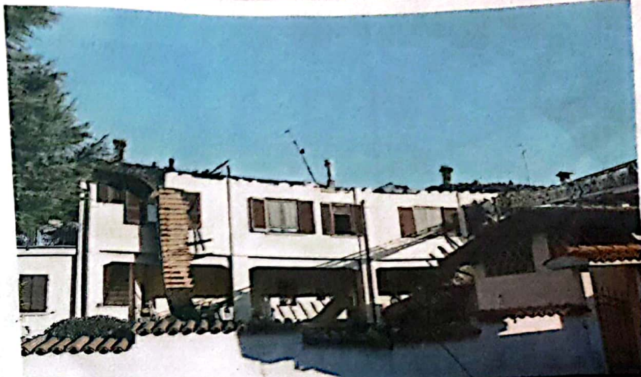
Distruzione. Questo ciò che resta del rogo che ha «mangiato» il tetto del cascinale // FOTO STRADA (NEG)
